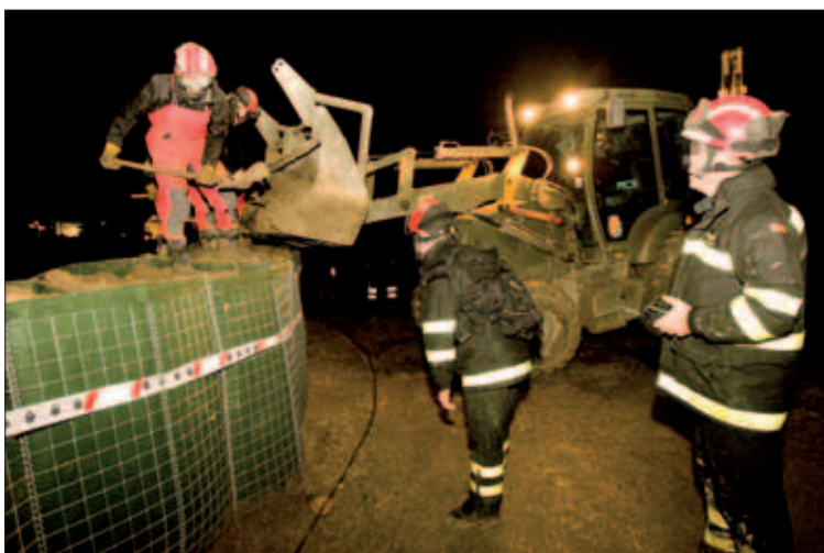
La actuación de la UME impidió que los daños fueran mayores
