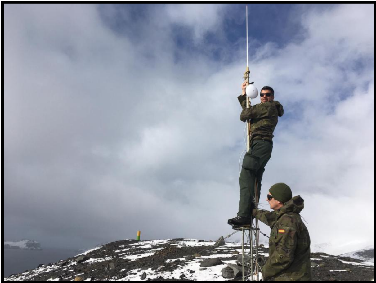
Semidesmontaje de la estación de Vértice Baliza
