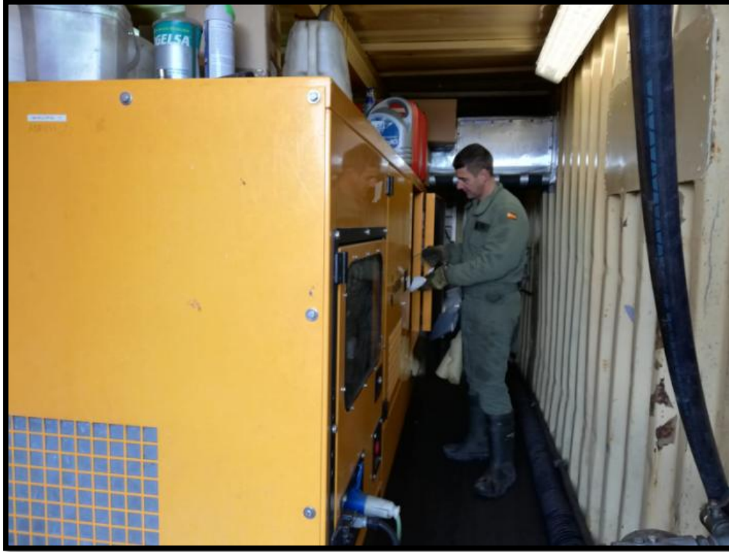
Revisión de los generadores
