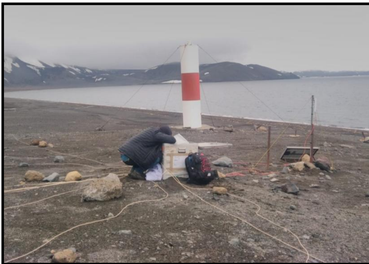
Cambio del regulador de carga del array
