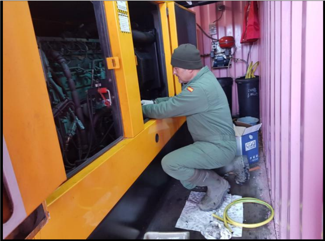
Revisión y puesta a punto de uno de los grupos electrógenos
