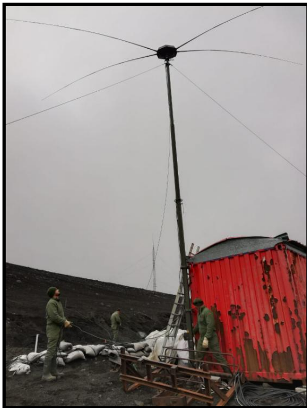
Antena de telecomunicaciones radio HF
