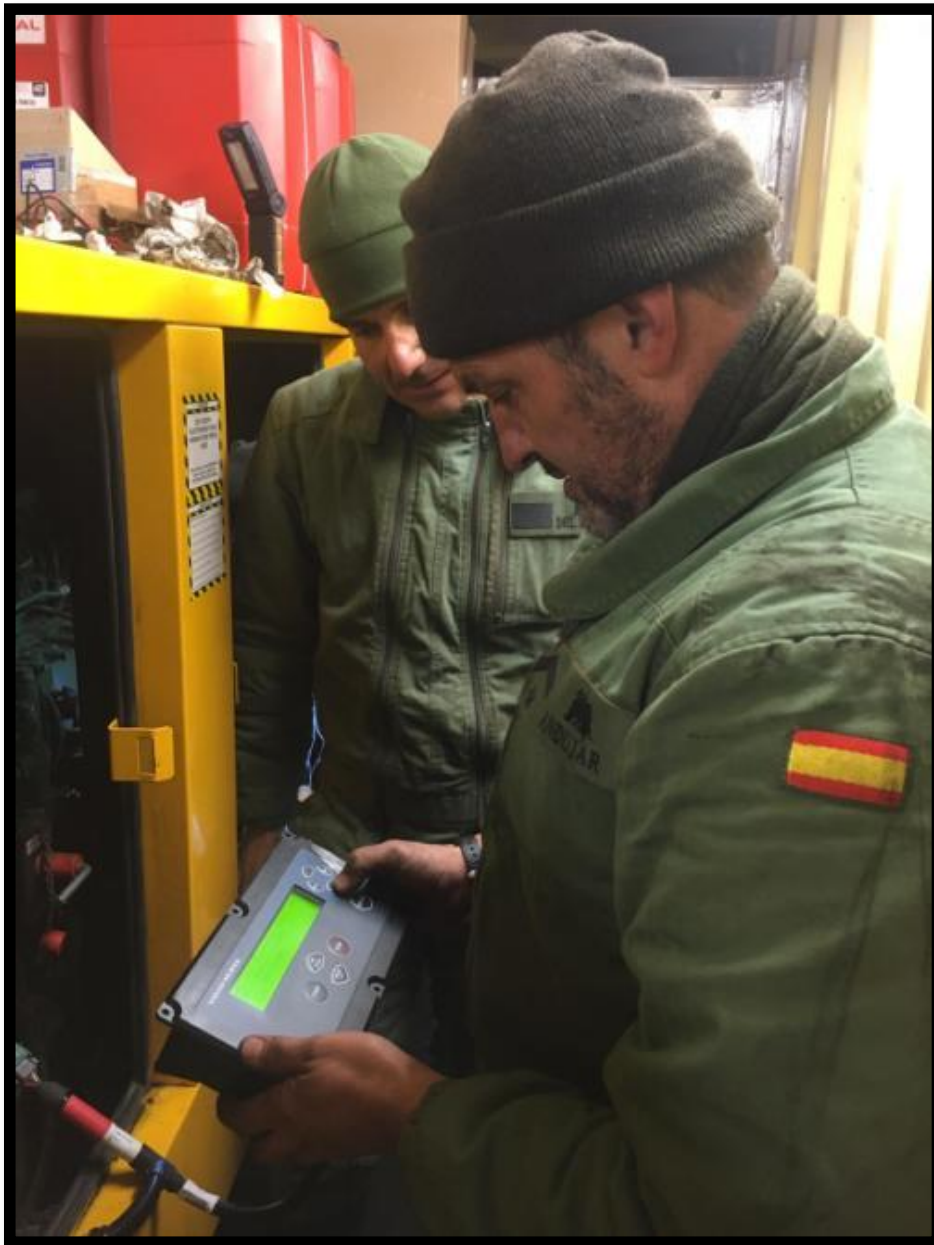
Control y reparación de la centralita del generador
