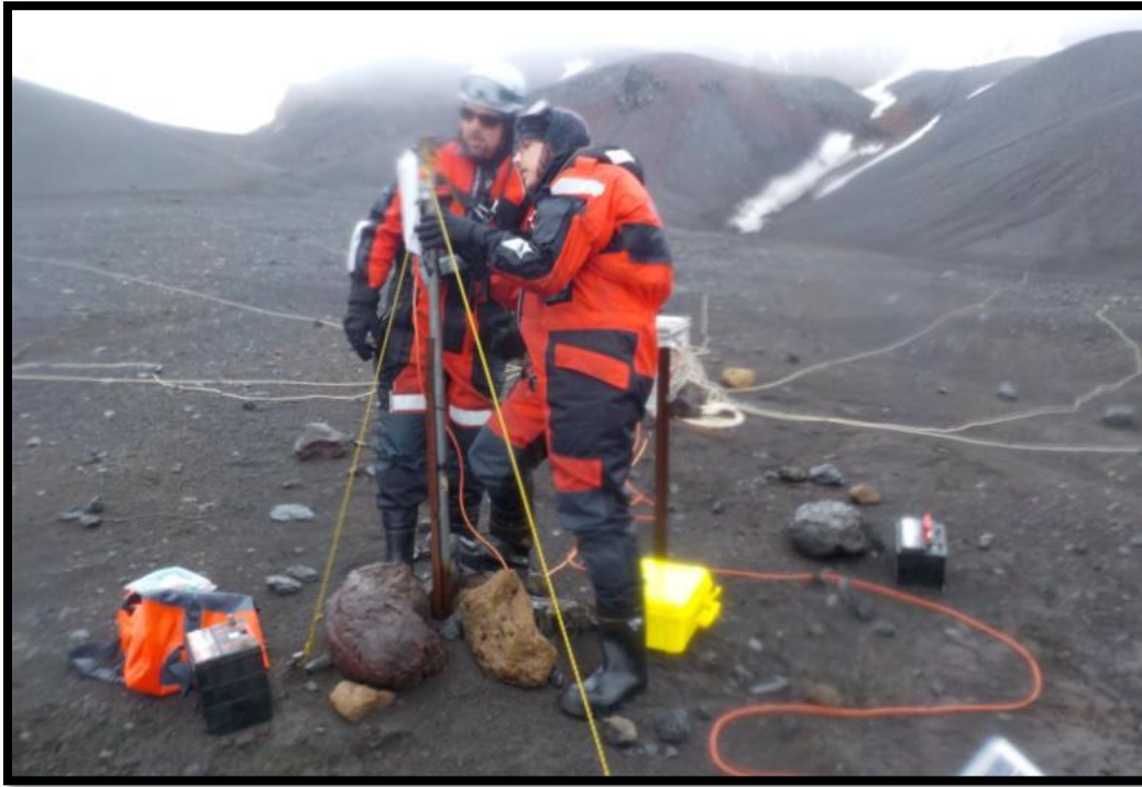
Revisión de la antena wifi del array situado en Fumarolas
