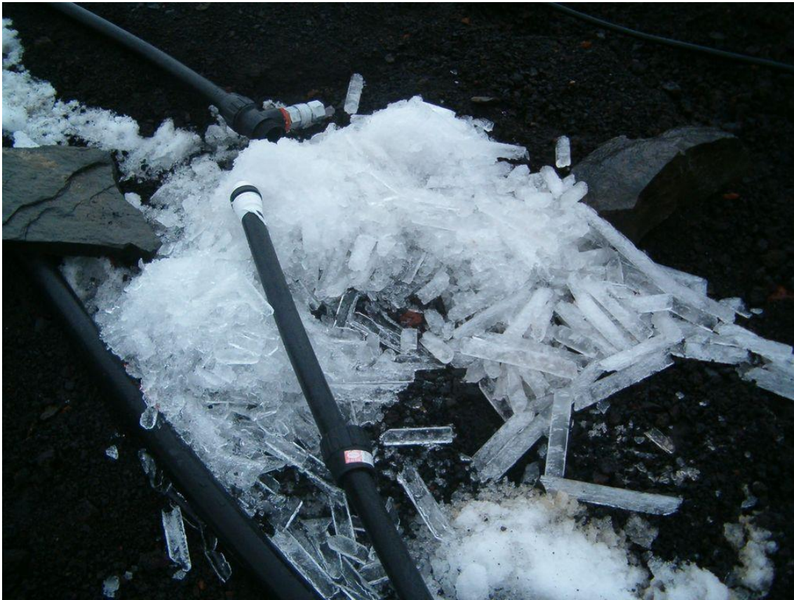
Efecto de las bajas temperaturas en la acometida de agua de la base.
