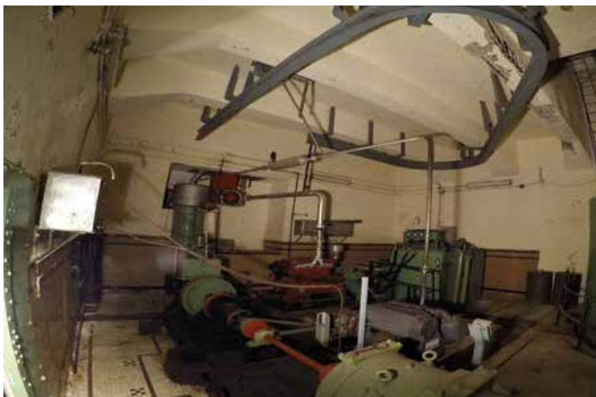
Sala de máquinas de Paloma Alta. Fotografía del autor
