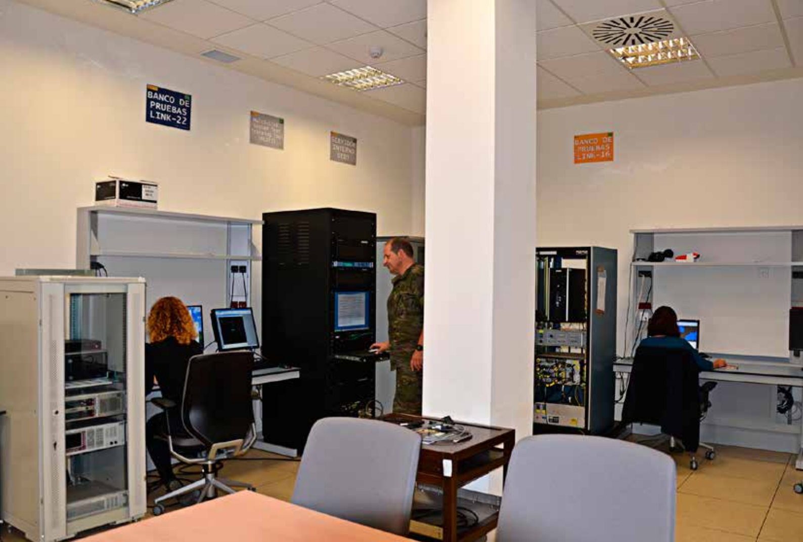
Instalaciones del Laboratorio de Enlaces de Datos Tácticos
