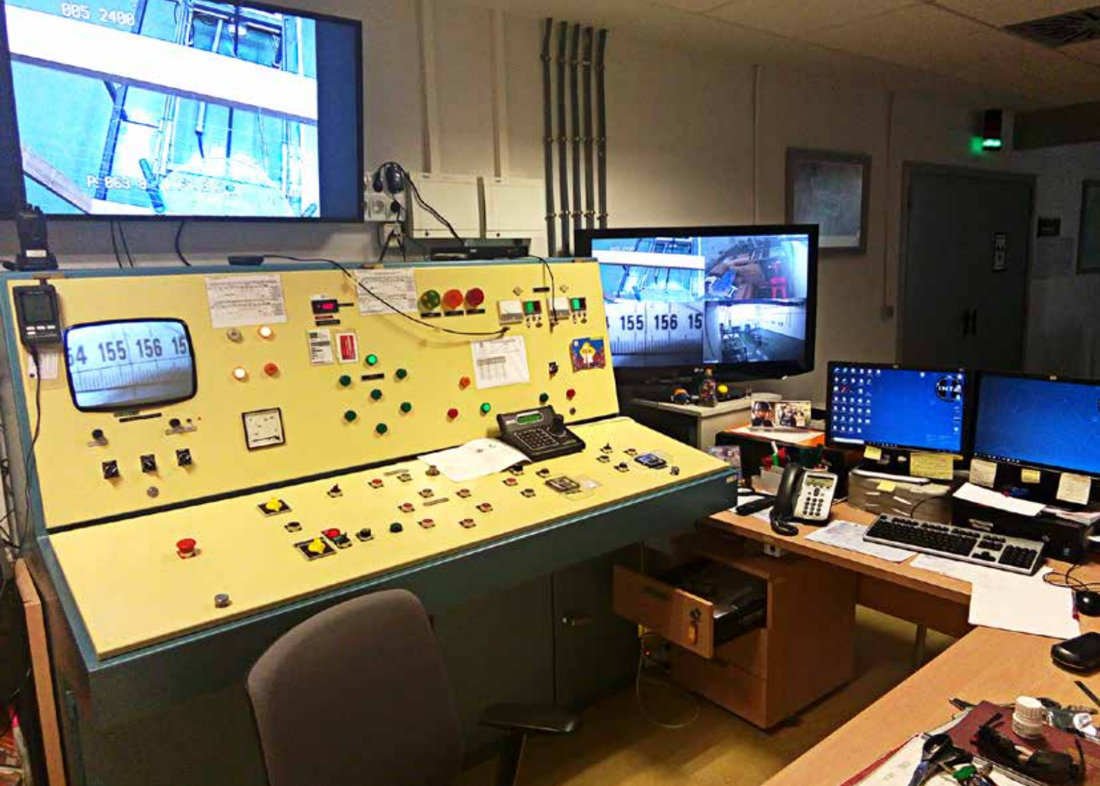
Dispositivos de control remoto del irradiador (LACAR)
