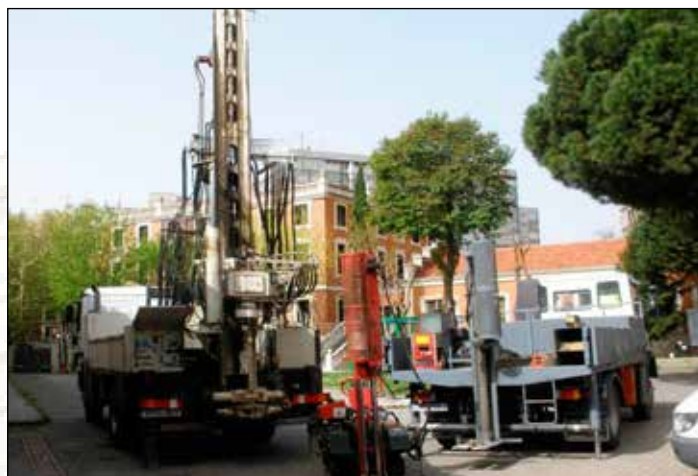
Equipos para ensayos geotécnicos del Laboratorio de Ingenieros del Ejército
