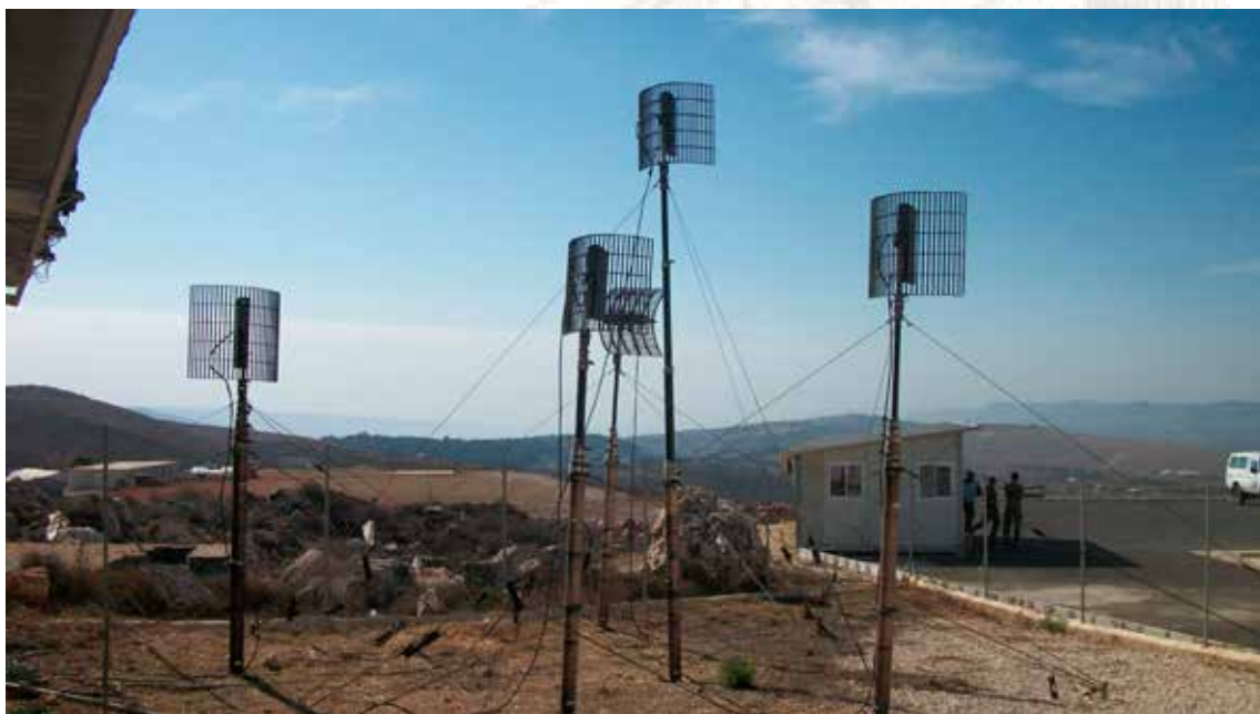
Campo de antenas en el Líbano
