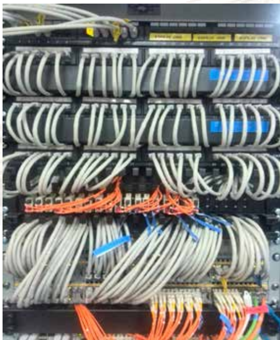
Paneles de parcheo. Plataforma MC 3
