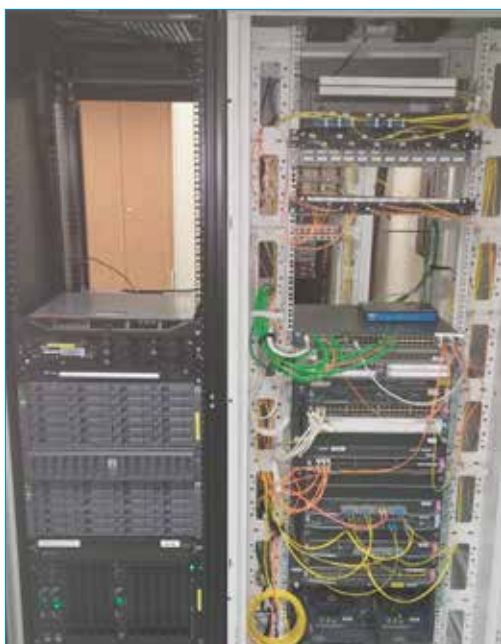
Equipamiento redundante en el segundo CPD (Centro de Procesamiento de Datos)
