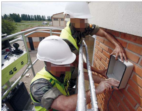
La Sección de Servicios Eléctricos suministra energía y alumbrado
