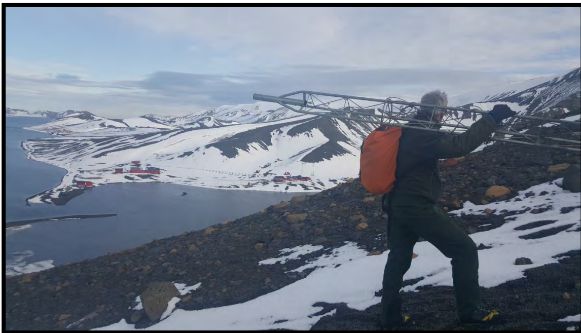
CIS colocan repetidor en Cerro Caliente
