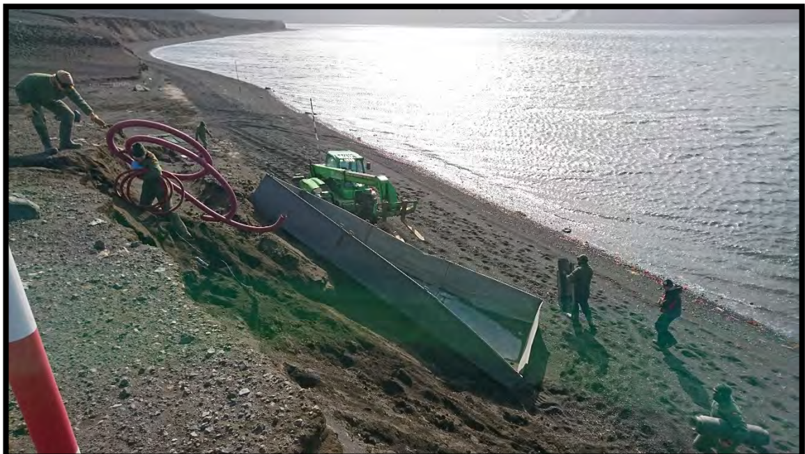
Cubierta metálica levantada por el viento y batida para recoger elementos
