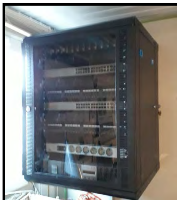
RACK en el módulo científico
