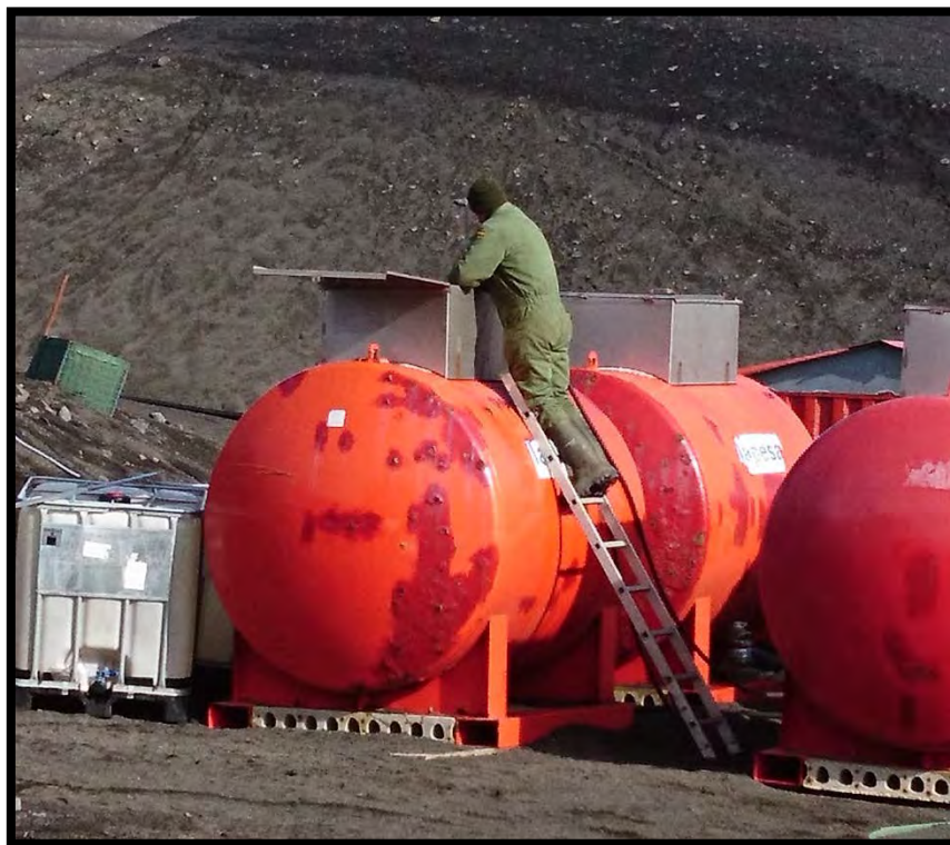
Trasvase de combustible área de motores
