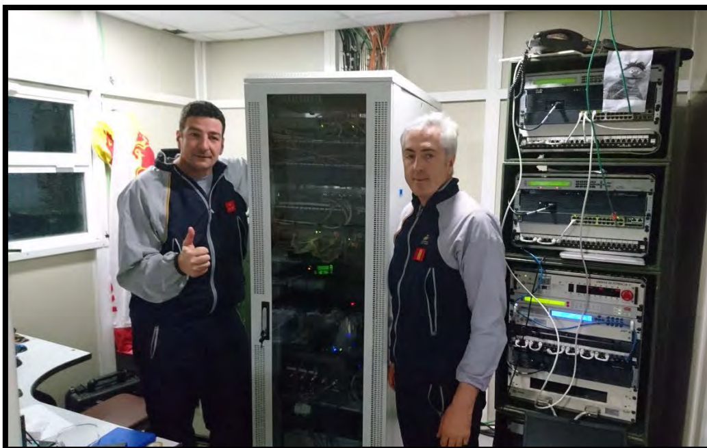
El área CIS con el RACK finalizado en el CECOM
