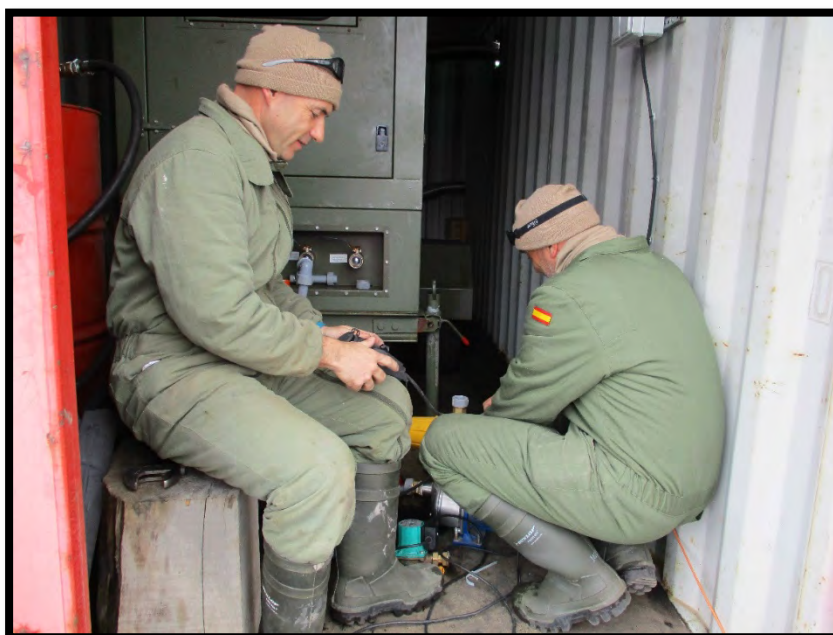
Los dos componentes de instalaciones trabajan en el módulo de cogeneración
