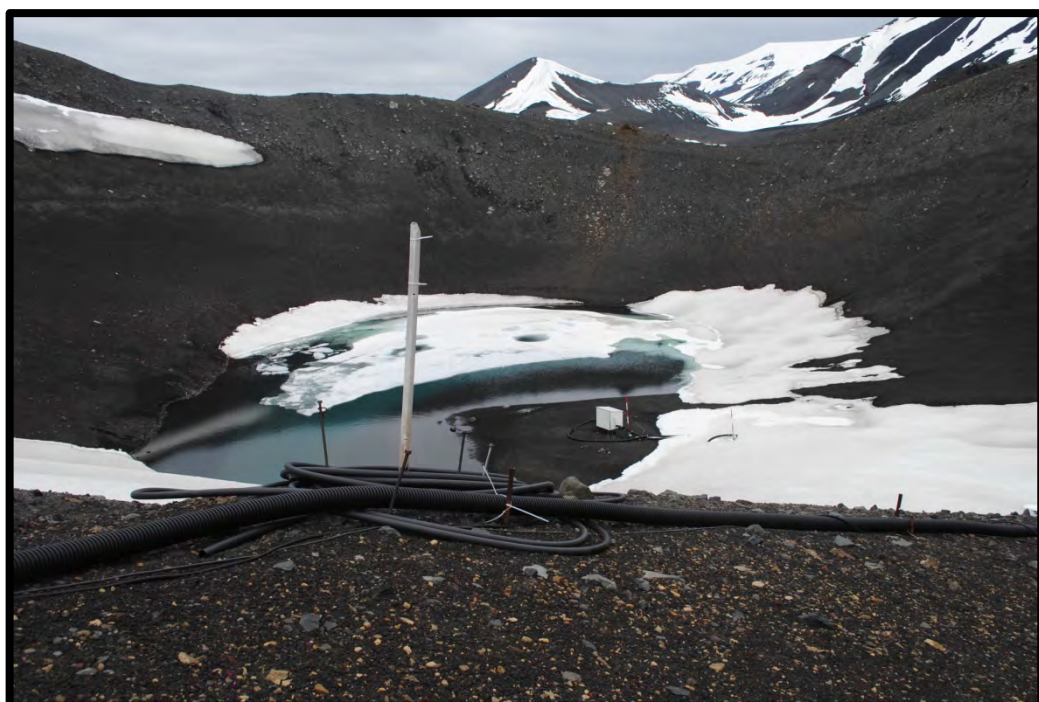
Cráter Zapatilla, instalaciones de suministro de agua
