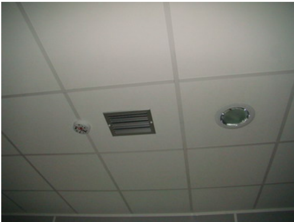
Aspecto que presenta el falso techo de una de las habitaciones del módulo dormitorio.
