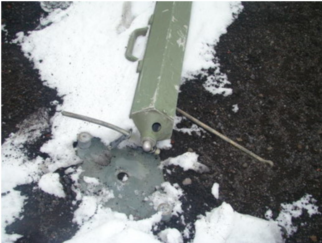
Efectos del fuerte viento sobre el mástil de una de las antenas de HF.
