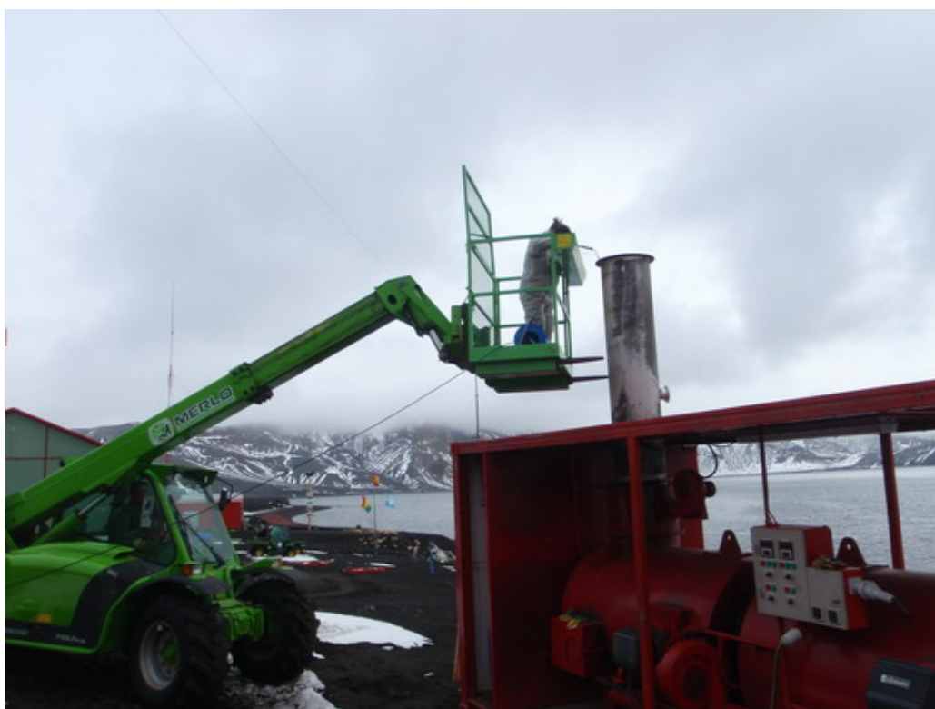
Tareas de control de emisiones de la incineradora de la BAE.
