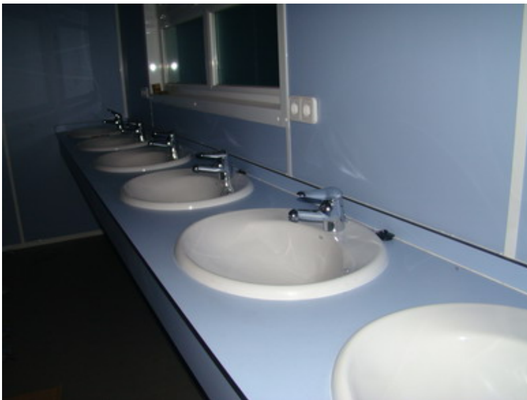
Vista de los lavabos instalados en el nuevo módulo dormitorio.
