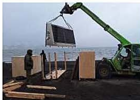
PREPARACION CASETAS IGN
