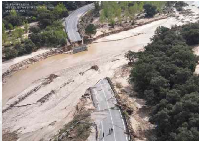
Ilustración 2. Imagen tomada desde Dron de los daños causados.
