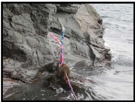
Mareógrafo instalado en la zona de Colatina
