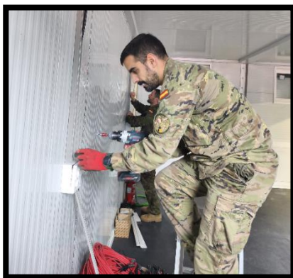
Carlos y Jesús colocando la canaleta para el cableado eléctrico en todas las estancias
