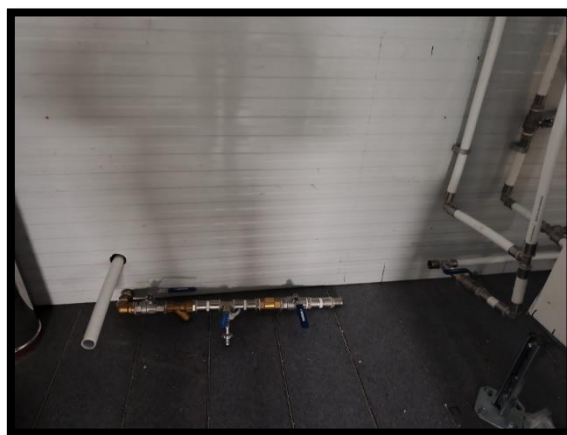
Acometida de agua del nuevo módulo científico
