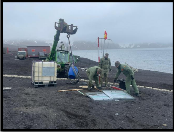
Vaciado de la fosa séptica, intervienen tres miembros de la dotación y material específico para la operación.
