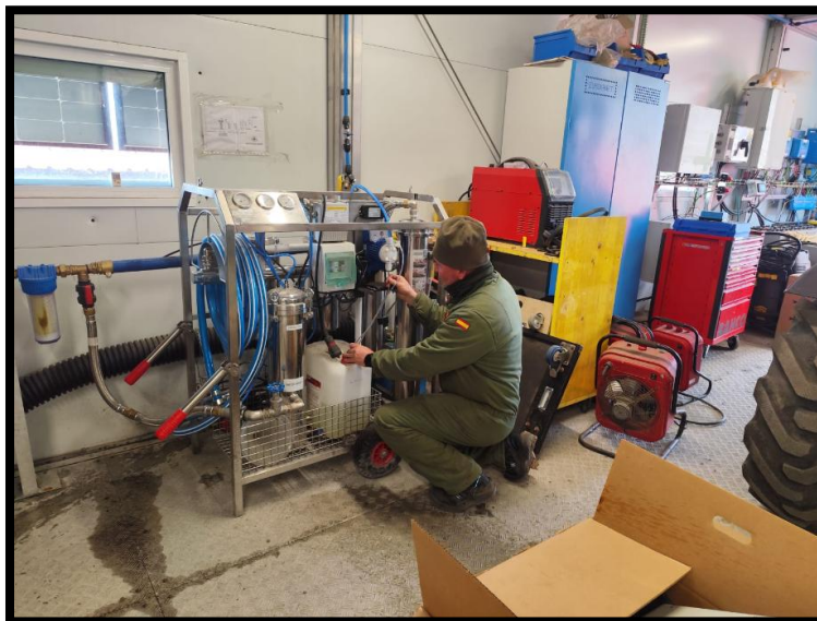
Fidel en el interior del taller con la potabilizadora
