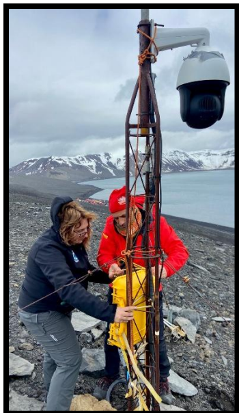
Instalación cámara DOMO, vértice Baliza
