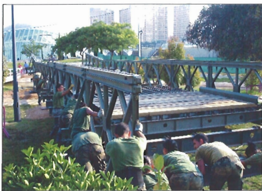
Ingenieros del RPEI nº 12 de Zaragoza montaron tres tramos de puente Bailey
