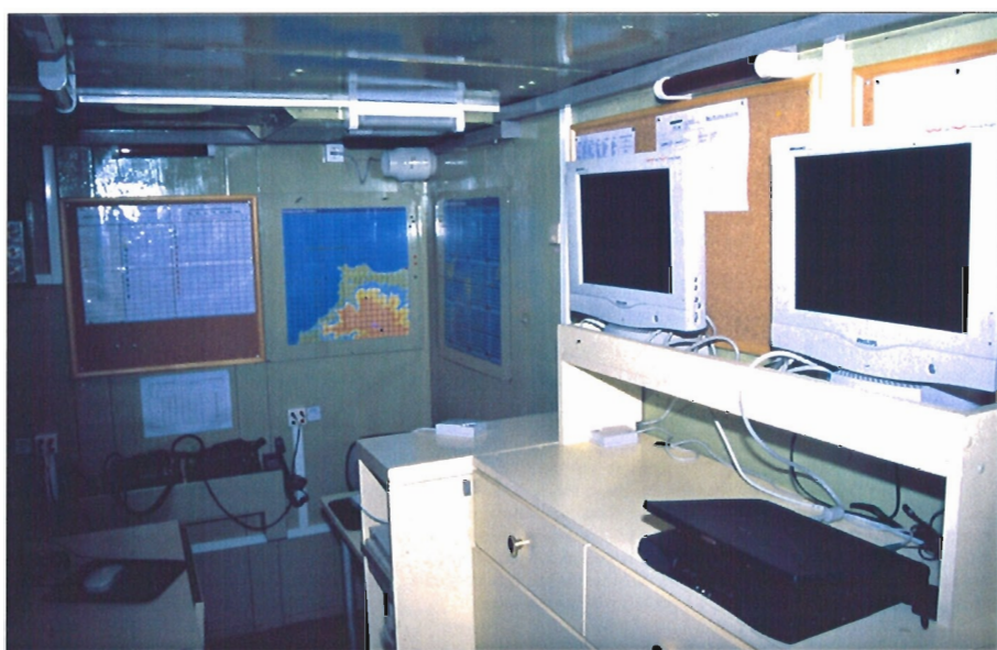
El puesto de mando del Centro de Operaciones de Artillería Antiaérea se encuentra en un shelter
