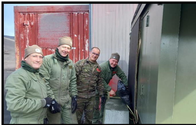
Antonio, Rodrigo, Javier Prados y Fidel acondicionando el grupo electrógeno para la invernada
