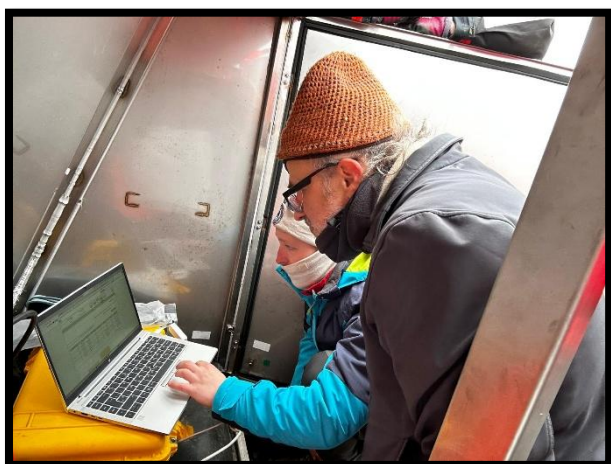
Sergio y Rafa configurando las antenas instaladas en la estación
