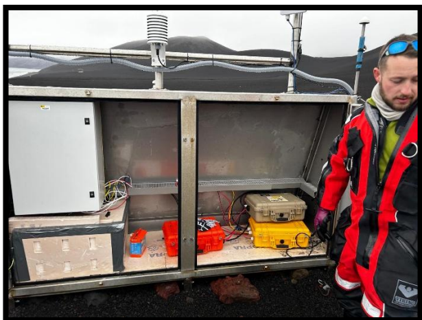
Sergio abriendo la estación para analizar la anomalía de funcionamiento
