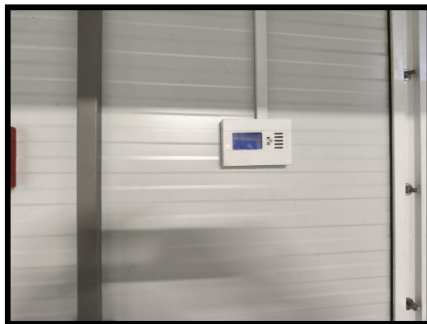
Comprobación del termostato del recuperador
