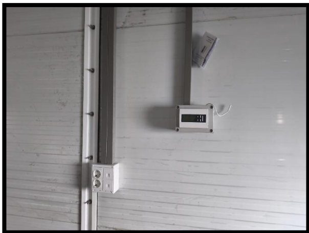
Programación del termostato del climatizador
