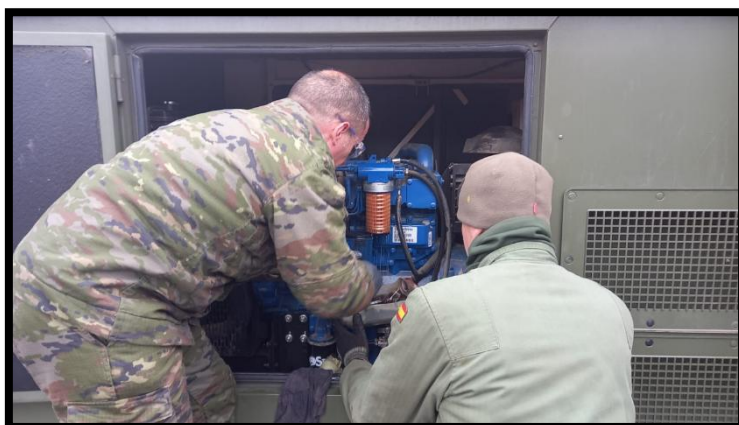
Javier Prados y Rodrigo realizando el mantenimiento al grupo electrógeno remolcado
