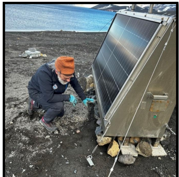
Rafa acondicionando la parte inferior de la estación FUM para evitar que pierda la base
