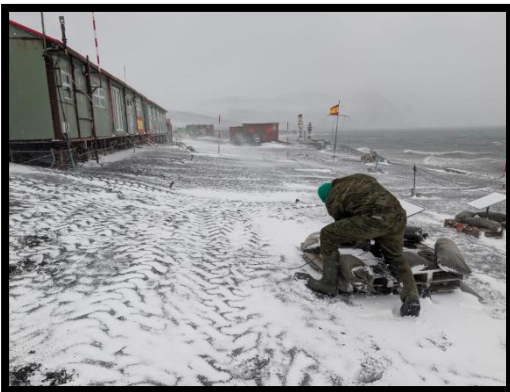
Área CIS realizando mantenimiento preventivo de terminal satélite
