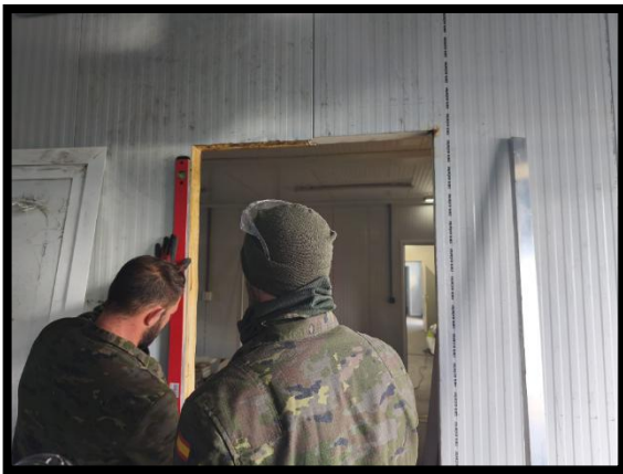
Ernesto y Fran nivelando los perfiles para la colocación de las puertas interiores
