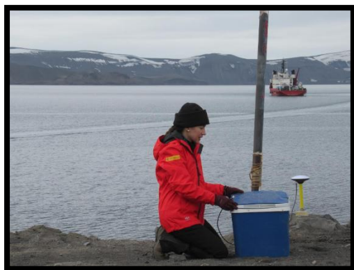
Belén terminando la instalación GPS
