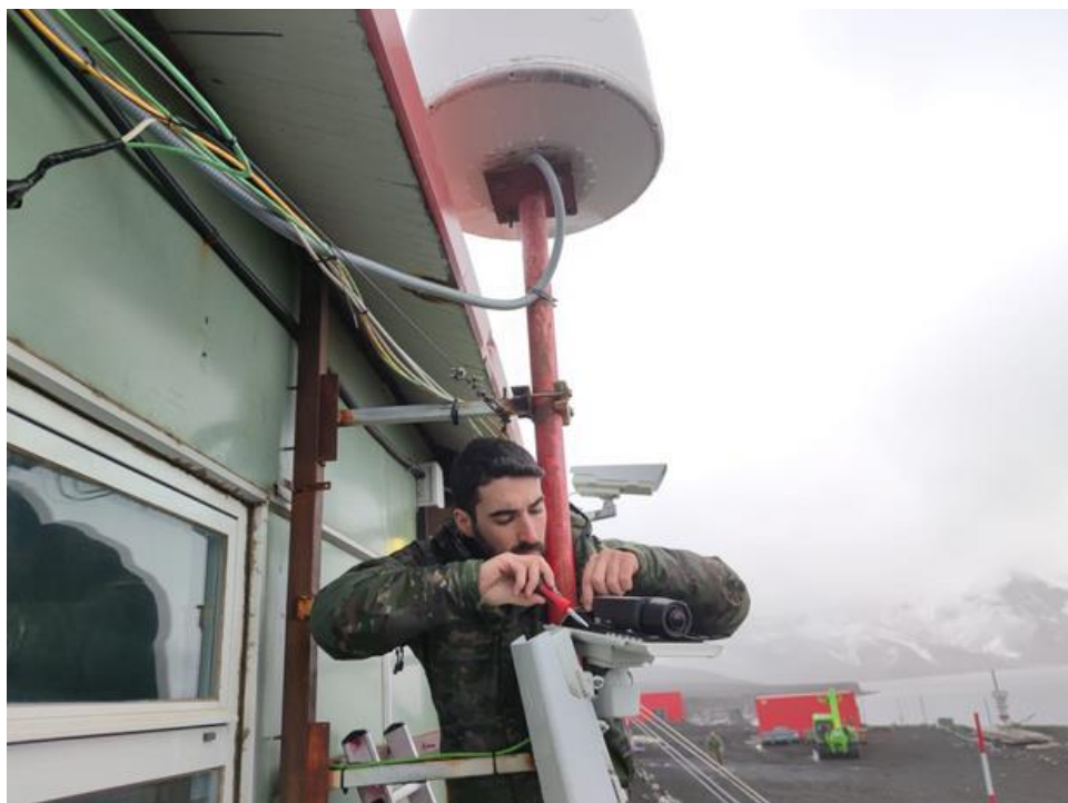
Nacho poniendo en funcionamiento la segunda cámara del sistema
