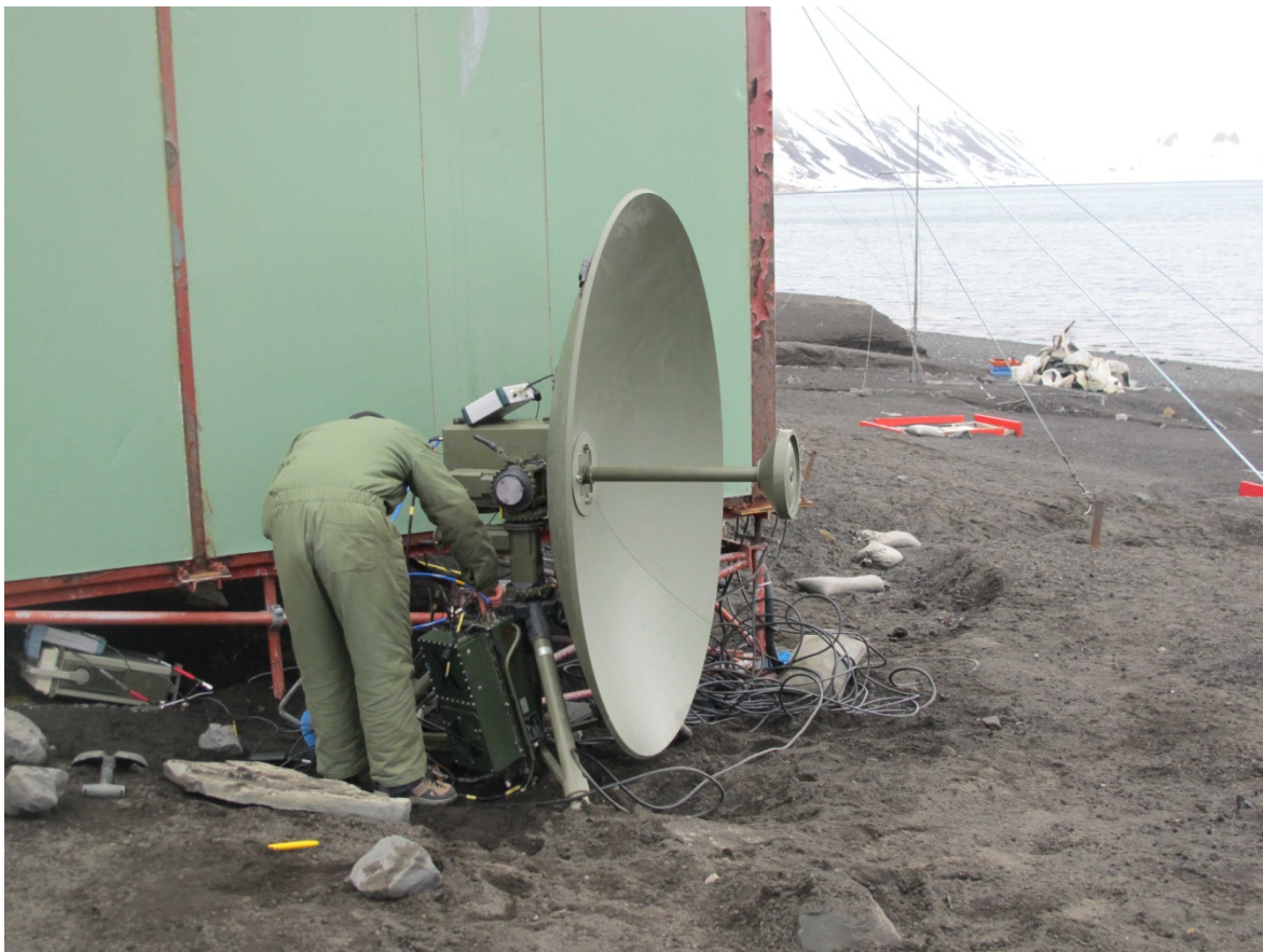
Instalación del TLB-50
