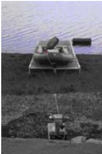
Cabestrante de la rampa de varada
